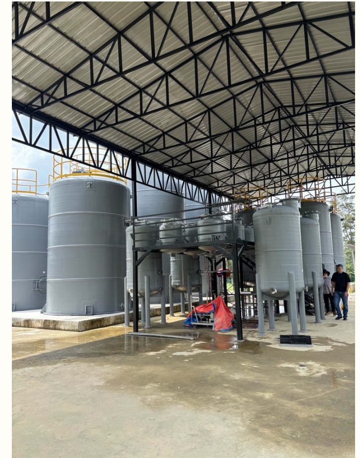
屋根下のタンクと周辺設備
