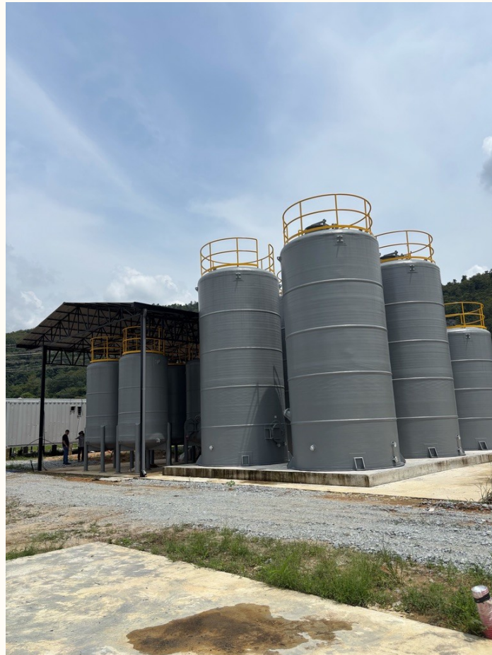
屋外のタンク全体
