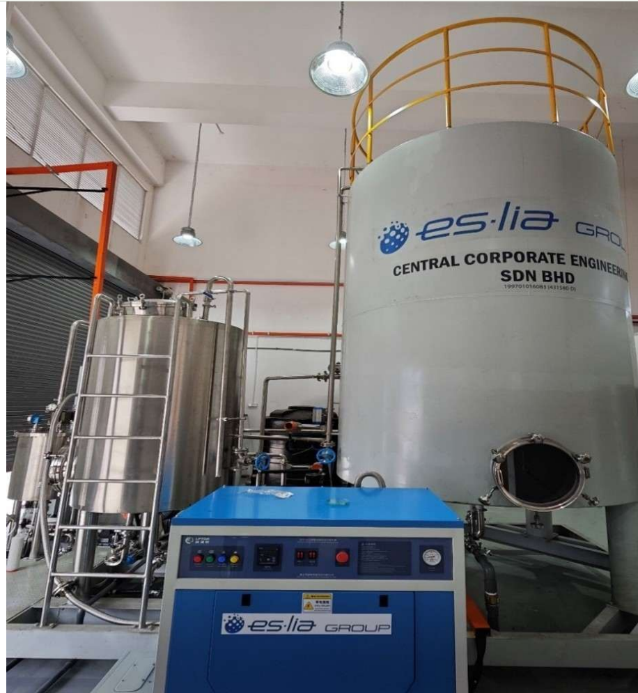
パイロットタンクの全体 | CCE 公式資料 p.10
